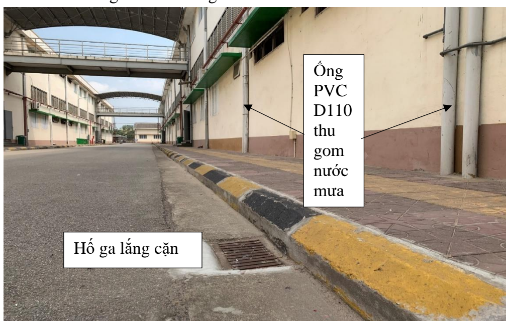
Hình 5. Hố ga lắng cặn và hệ thống ống nhựa PVC thu gom nước mưa
