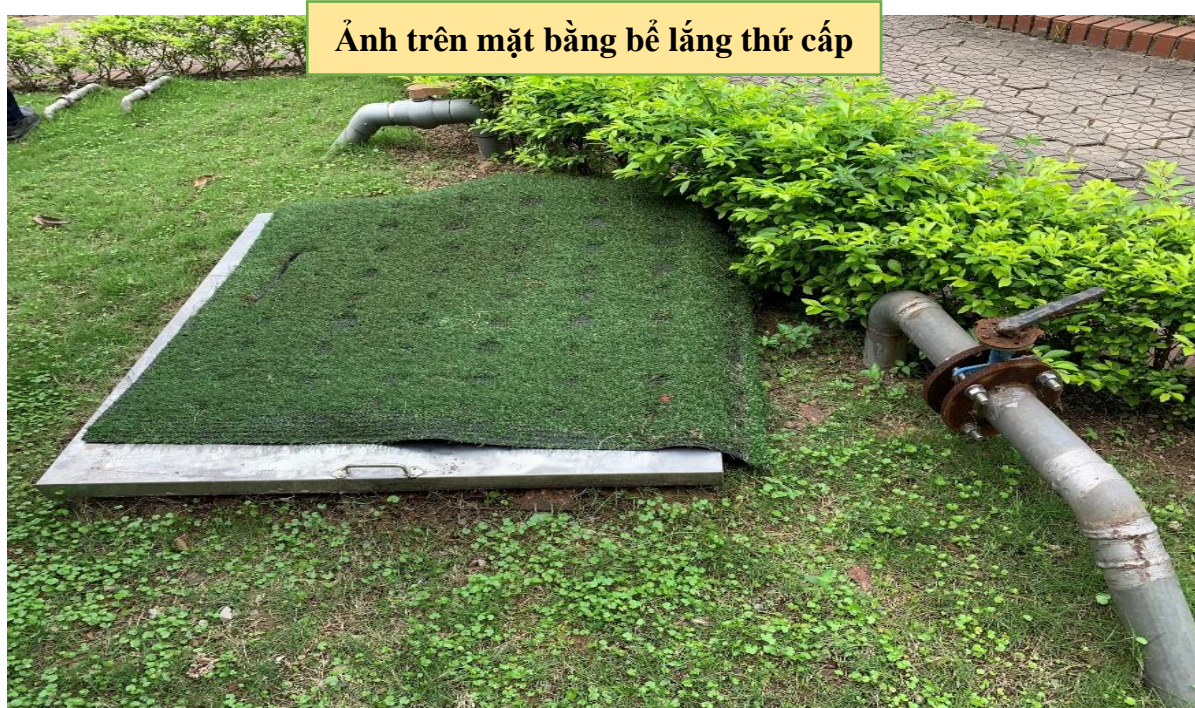
Hình 16. Bể lắng thứ cấp
