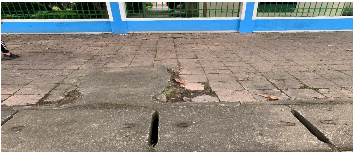
Hình 7. Ảnh vị trí cửa xả nước mưa số 2
