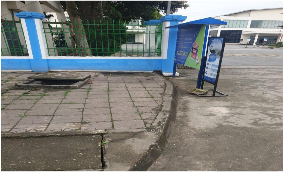
Hình 8. Ảnh vị trí cửa xả nước mưa số 3
