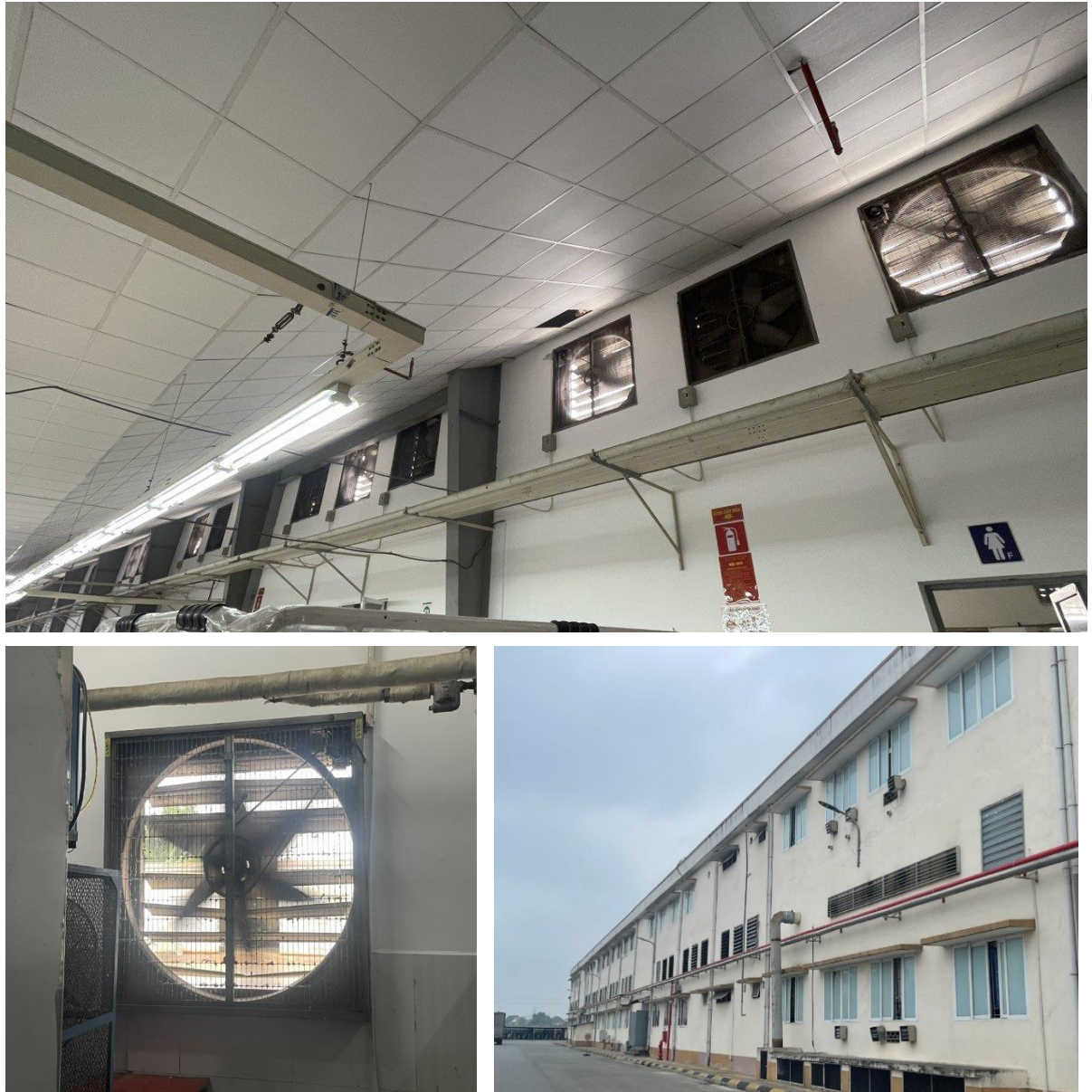
Hình 19. Hệ thống quạt hút gió nhà xưởng
