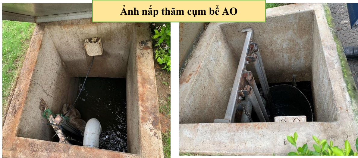
Hình 15. Cụm Bể sinh học AO
